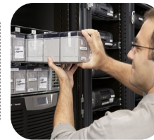
Banco de Baterías
